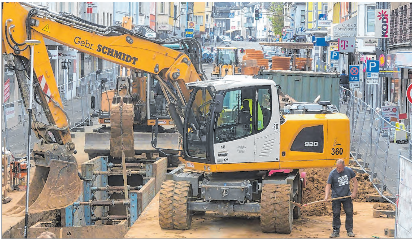
Die Arbeiten am ersten Bauabschnitt der Rathausstraße laufen. Das heißt aber noch lange nicht, dass für die BI Wissen das Bürgerbegehren damit erledigt wäre. Foto: damo
