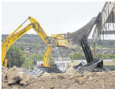
Als die RZ vor Ort ist, geht es dem Dach der Großturnhalle ans Leder.
