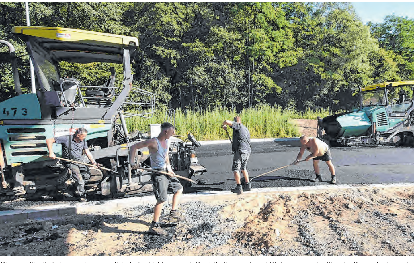
Die neue Straße bekam gestern eine Feindeckschicht verpasst. Zwei Fertiger und zwei Walzen waren im Einsatz. Dennoch ging es im Kurvenbereich nicht ohne Handarbeit der Straßenbauer. Fotos: rai
